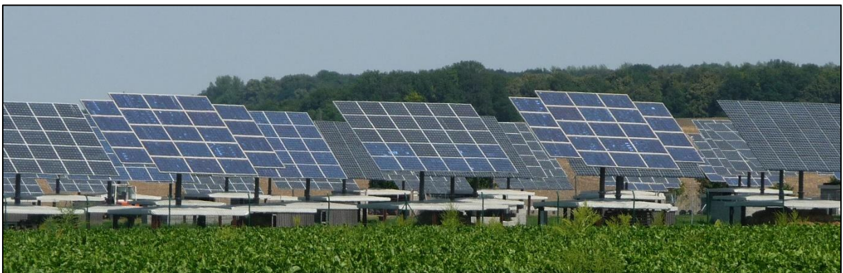
Abb. 41: Photovoltaikanlagen (hier auf Freiflächen)
