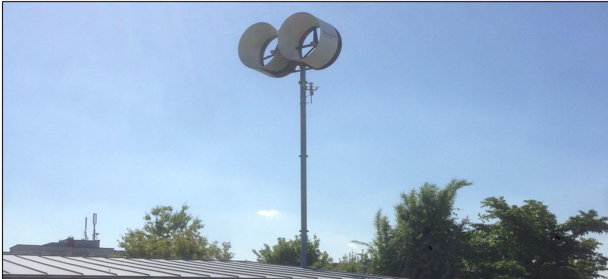
Abb. 46: Kleinstwindkraftanlage an einem Wohngebäude
