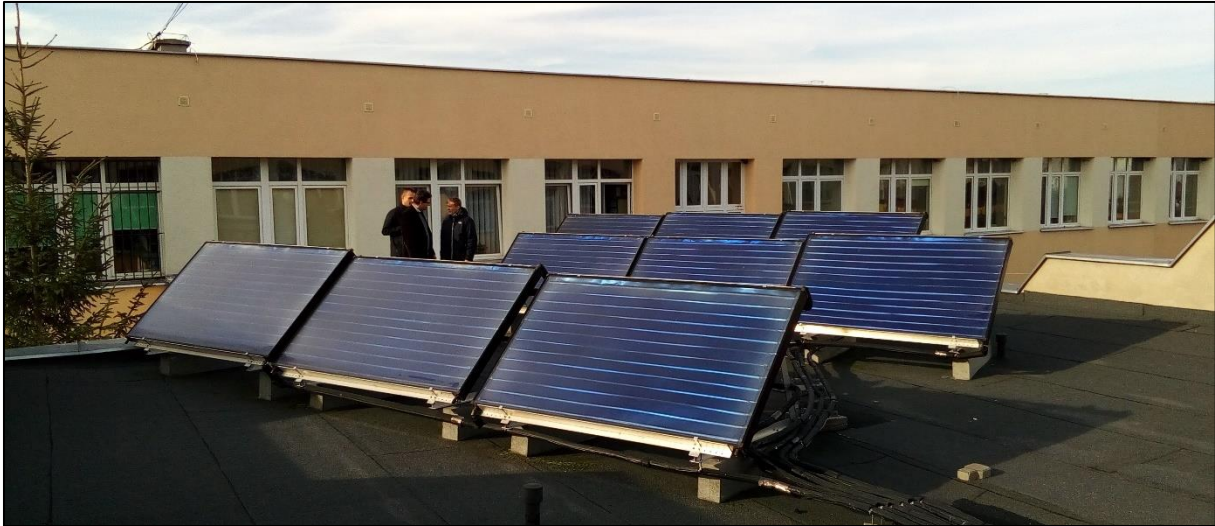
Abb. 40: Solarthermieanlage auf dem Dach einer Schule
